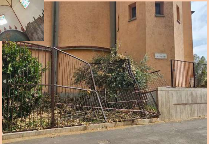
Recinzione metallica Via Millelire divelta da un platano caduto
