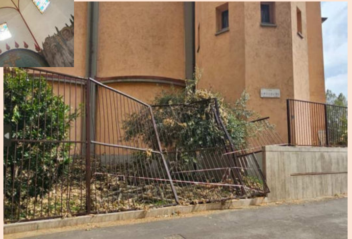
Recinzione metallica Via Millelire divelta da un platano caduto
